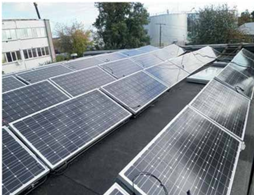
Pirmā saules enerģijas elektrostacija rūpnieciskām vajadzībām Latvijā – uzstādītās SIA „Eko Osta” teritorijā.
